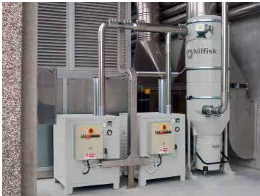
Sistema de vácuo centralizado em uma empresa química: 2 unidades de vácuo, 1 silo de filtro.
